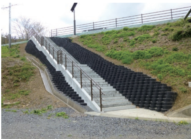
施主：東北地方整備局三陸国道事務所 工事名：大船渡金石地区交通安全施設設置工事 ■ 壁面勾配：1：0.5 ■ 壁高：2.4m ■ 壁面積：80㎡
