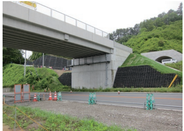
施主：岩手県宮古土木センター 工事名：市道宮古北部環状線 ■ 壁面勾配：1 : 0.5 ■ 壁高：4.5m ■ 壁面積：85㎡
