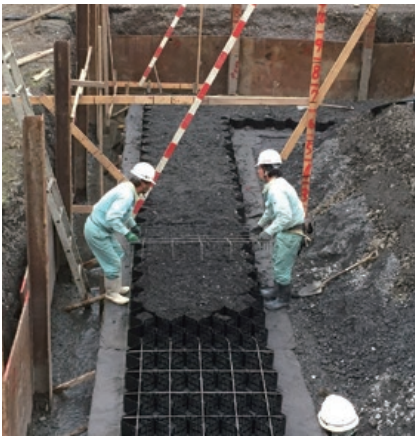
施主：熊本県芦北町役場 工事名：第4分団消防ポンプ格納庫新築工事 ■ 概要：T-150MP×2段
