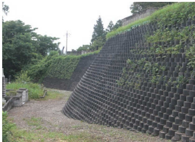
施主：群馬県渋川市役所 工事名：渋川市有墓地のり面擁壁工事 ■ 壁面勾配：1：0.5 ■ 壁高：5.25m ■ 壁面積：420㎡
