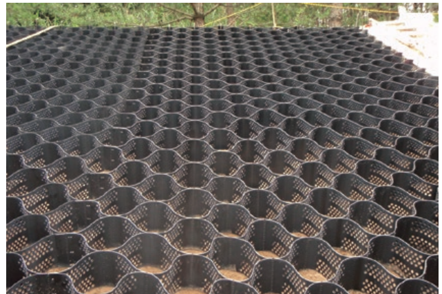
施主：東京電力株式会社 工事名：刈羽原子力発電所内のり面復旧工事 ■ 型式：T-150MP ■ のり面勾配：1：1.4、1.5 ■ のり面積：1,500㎡ ■ 型式：T-150LP ■ のり面勾配：1：1.6、1.7、1.8 ■ のり面積：700㎡
