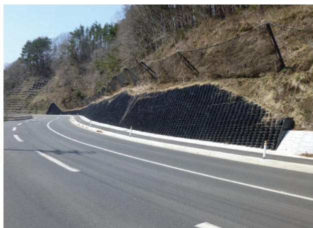
施主：東北地方整備局三陸国道事務所 工事名：田老地区改良工事 ■ 壁面勾配：1：0.5 ■ 壁高：4.5m ■ 壁面積：457㎡
