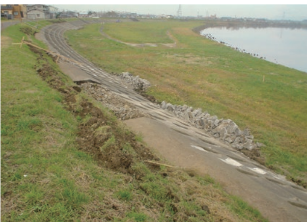
施主：能代河川国道事務所東北地方整備局 工事名：H16 中川原地区護岸補修工事 ■ のり面勾配：1：2.0 ■ 型式：T-100LP ■ のり面積：6,415㎡
