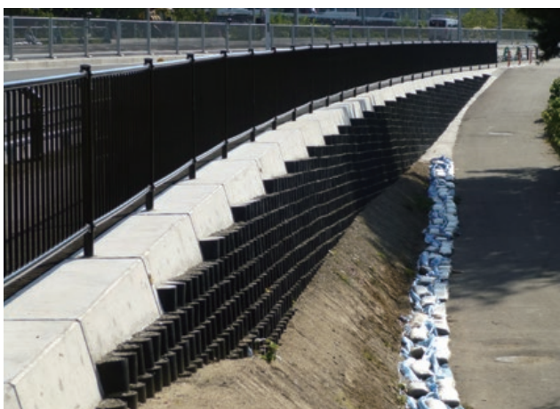
施主：東北地方整備局福島河川国道事務所 工事名：仲間町地区交通安全対策工事 ■ 壁面勾配：1：0.5 ■ 壁高：1.8m ■ 壁面積：140㎡
