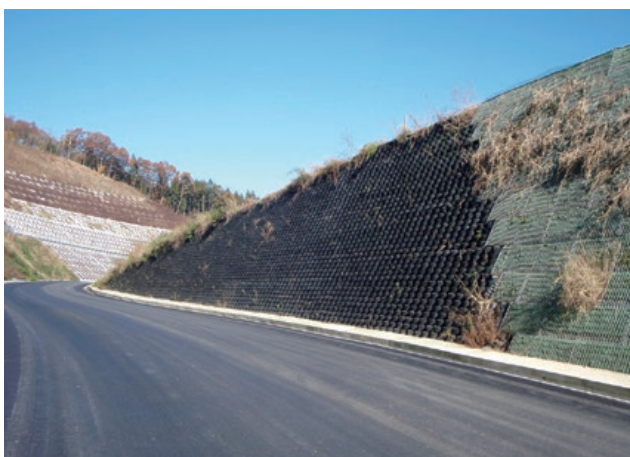
施主：北陸地方整備局新潟国道事務所 工事名：日沿道村上IC改良その2工事 ■ 壁面勾配：1：0.5 ■ 壁高：6.6m ■ 壁面積：230㎡
