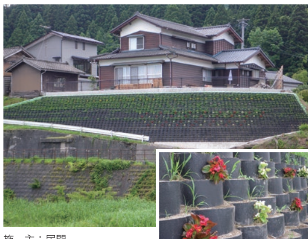
施主：民間 工事名：新潟県関川村田村邸敷地内法面工事 ■ 壁面勾配：1：0.5 ■ 壁高：5.0m ■ 壁面積：120㎡
