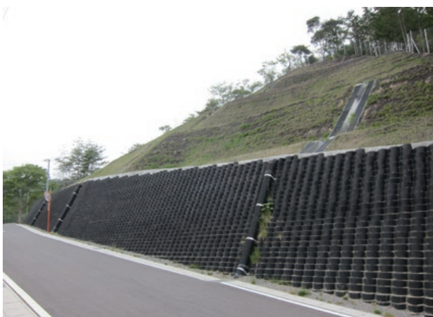
施主：宮城県石巻市役所 工事名：牡鹿地区防災集団移転宅地造成工事 ■ 壁面勾配：1：0.5 ■ 壁高：4.35m ■ 壁面積：330㎡
