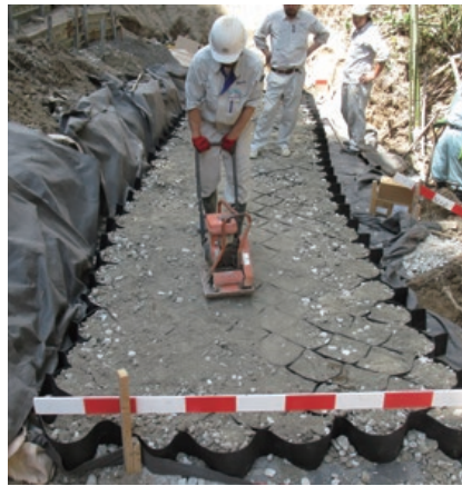
施主：新潟県佐渡市役所 工事名：市道浜中1号線 ■ 概要：T-150MP×2段
