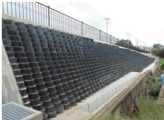
施主：茨城県水戸土木事務所 工事名：主要地方道大洗友部線 ■ 壁面勾配：1：0.5 ■ 壁高：3.9m ■ 壁面積：216㎡
