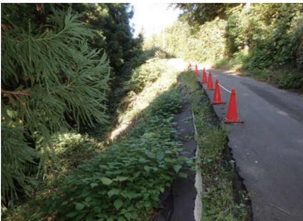
施主：新潟県十日町市役所 工事名：市道猿倉線道路災害復旧工事 ■ 壁面勾配：1 : 0.5 ■ 壁高：2.25m ■ 壁面積：40㎡
