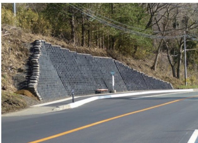
施主：東北地方整備局岩手河川国道事務所 工事名：国道4号BP芋田地区擁壁工事 ■ 壁面勾配：1：0.5 ■ 壁高：4.65m ■ 壁面積：190㎡
