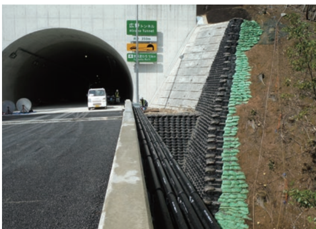
施主：近畿地方整備局福知山河川国道事務所 工事名：丹波綾部道路大簾地区舗装工事 ■ 壁面勾配：1：0.5 ■ 壁高：7.95m ■ 壁面積：145㎡
