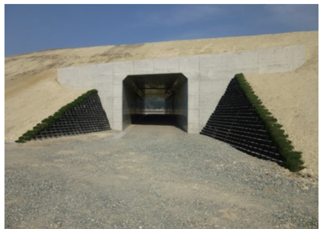
施主：東北地方整備局山形河川国道事務所 工事名：土生田道路改良工事 ■ 壁面勾配：1 : 0.5 ■ 壁高：4.35m ■ 壁面積：90㎡
