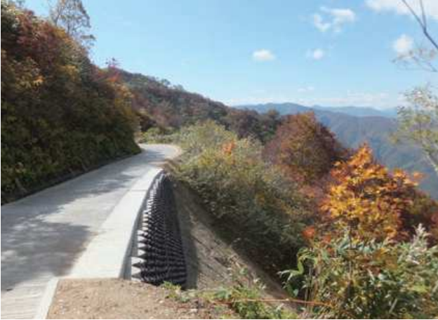
施主：富山県富山市八尾総合行政センター 工事名：白木峰市有施設管理道整備工事
