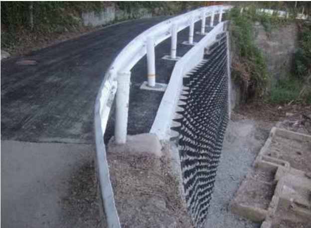
施主：兵庫県神戸市西部建設事務所 工事名：大日第 89 号線道路防災工事
